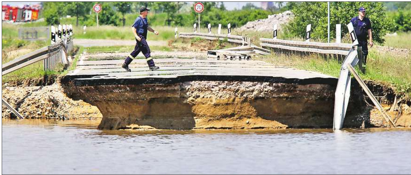
Zwei Feuerwehrmänner inspizieren eine vom Hochwasser der Mulde zerstörte Straße bei Löbnitz (Sachsen).
